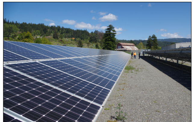
Blue Lake Rancheria microgrid solar array
